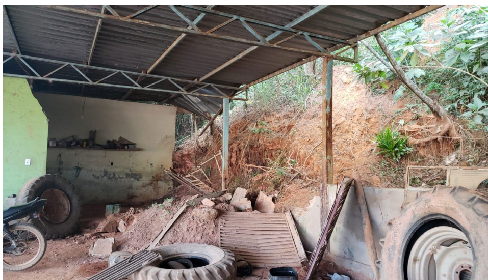
Figura 33. Vista de local de escorregamento de solo na garagem da prefeitura municipal (Foto: Luciene Menezes)
